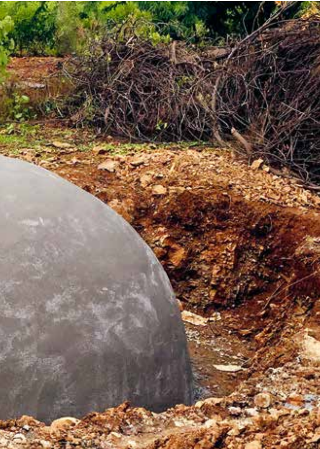
Biogasanlage im Distrikt Kolar in Indien.
