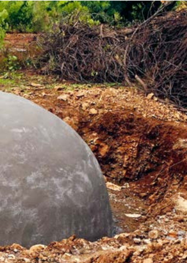
Biogasanlage im Distrikt Kolar in Indien.
